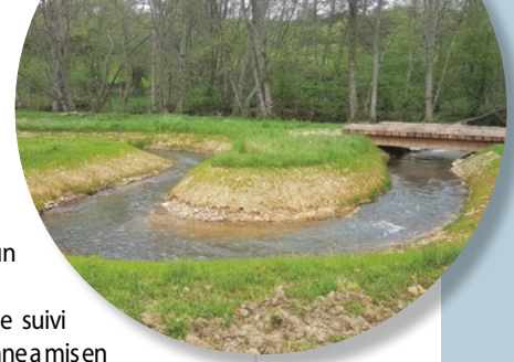
Bras de contournement, 1 er méandre, 6 mois après travaux © EPAGE Bassin du Loing
